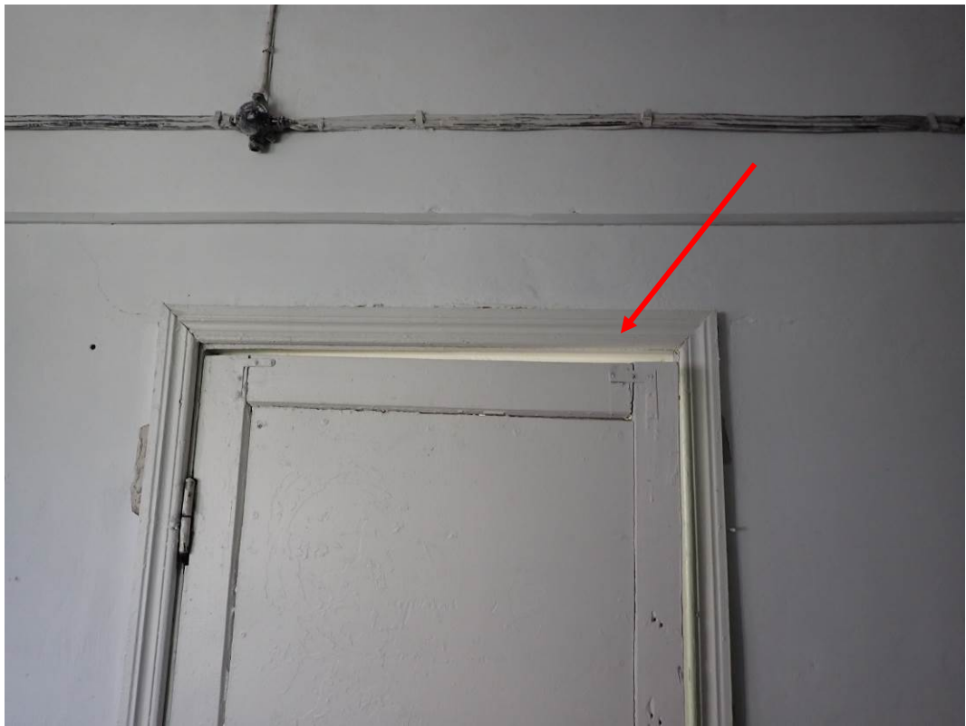
Фото 52. Перекос дверных блоков внутри здания.
