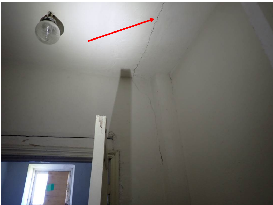
Фото 30. Трещины в швах между плитами чердачного перекрытия, повреждение отделочного слоя.
