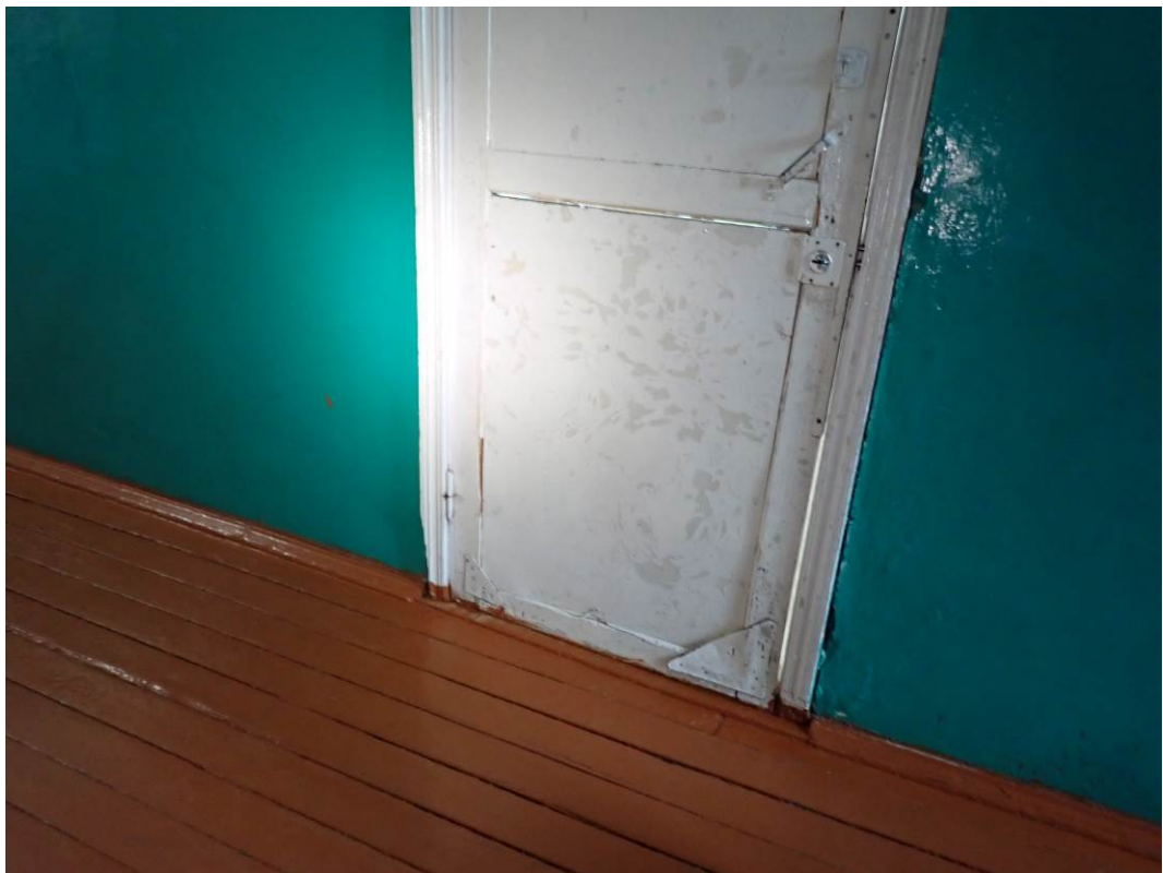
Фото 53. Повреждение деревянных полотен внутренних дверей.
