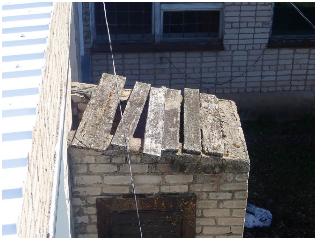
Фото 74. Повреждение покрытия наружной кирпичной шахты.
