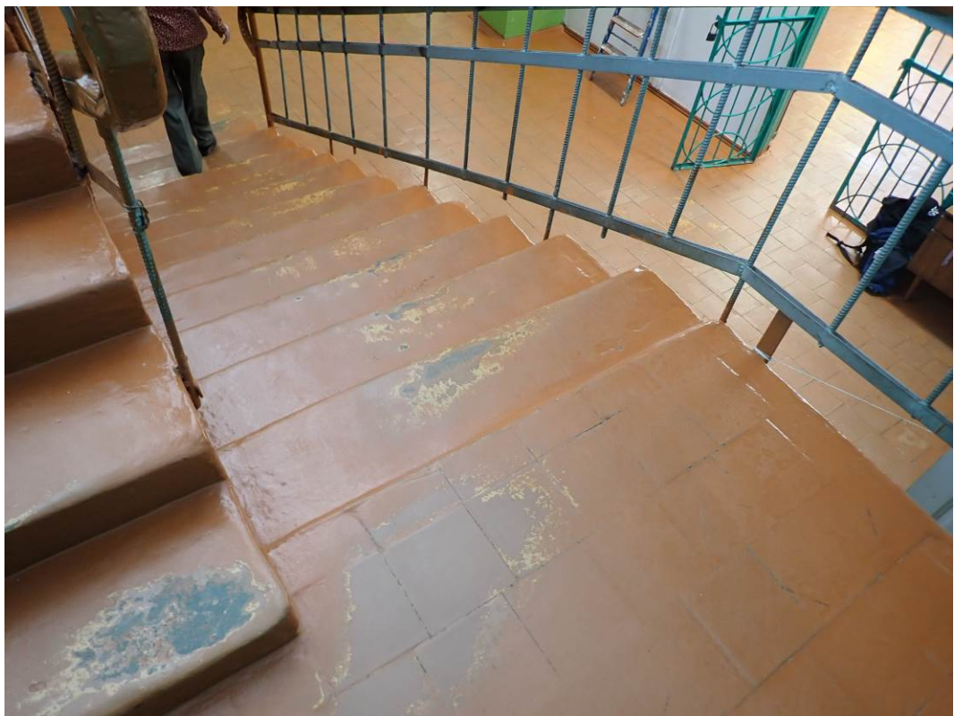
Фото 98. Истирание окрасочного слоя внутренних лестниц здания.
