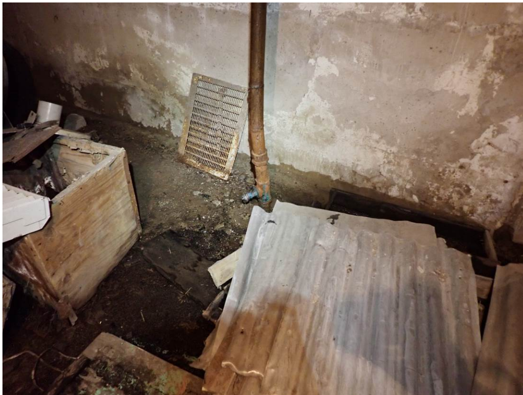
Фото 86. Коррозия металла трубопроводов инженерных коммуникаций, протечки.
