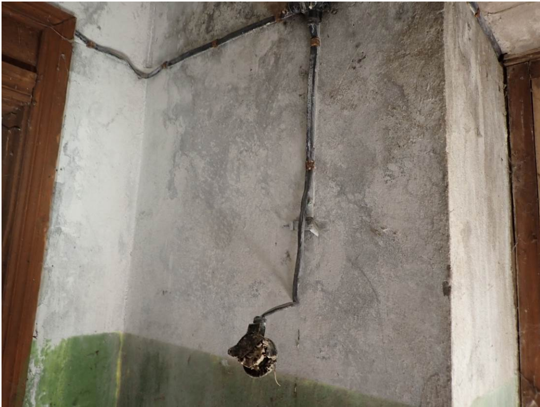
Фото 88. Моральный и физический износ электрических сетей здания.
