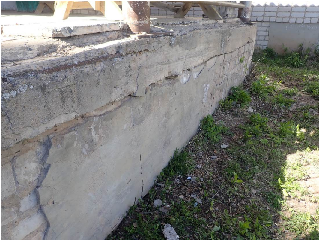
Фото 95. Повреждение кирпичной кладки ограждающих конструкций крыльца главного входа, повреждение штукатурного слоя.
