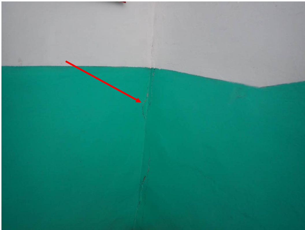
Фото 25. Наличие трещин в местах стыка смежных конструкций стен.
