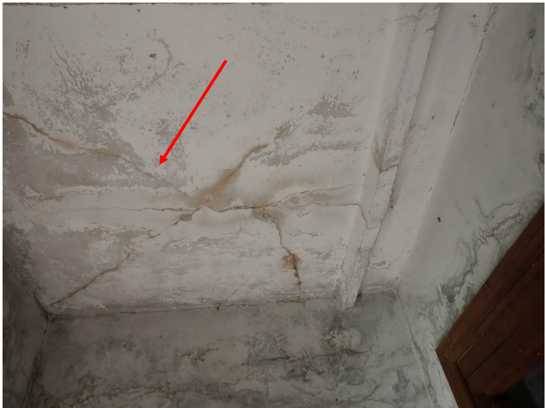
Фото 29. Наличие трещин в теле плиты междуэтажного перекрытия.
