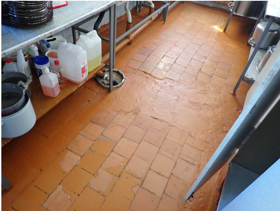
Фото 45. Повреждение покрытия полов из керамической плитки, наличие трещин, локальное отсутствие плиток.
