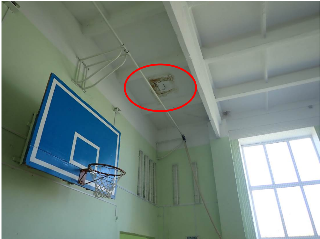
Фото 69. Повреждение штукатурного и окрасочного слоя потолков внутри здания вследствие замачивания.
