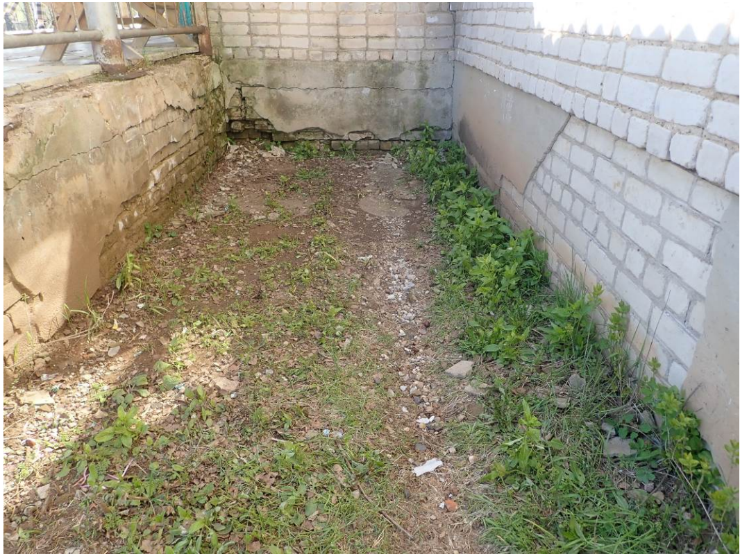
Фото 4. Локальное отсутствие бетонной отмостки здания. Замачивание цоколя, биопоражение, повреждение штукатурного слоя и кирпичной кладки.
