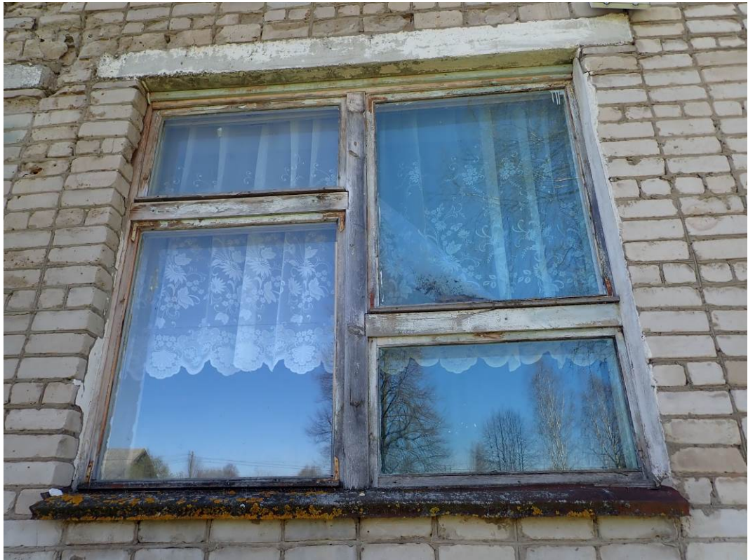
Фото 48. Гниение деревянных оконных блоков, биопоражение, повреждение окрасочного слоя. Коррозия металла оконных отливов.
