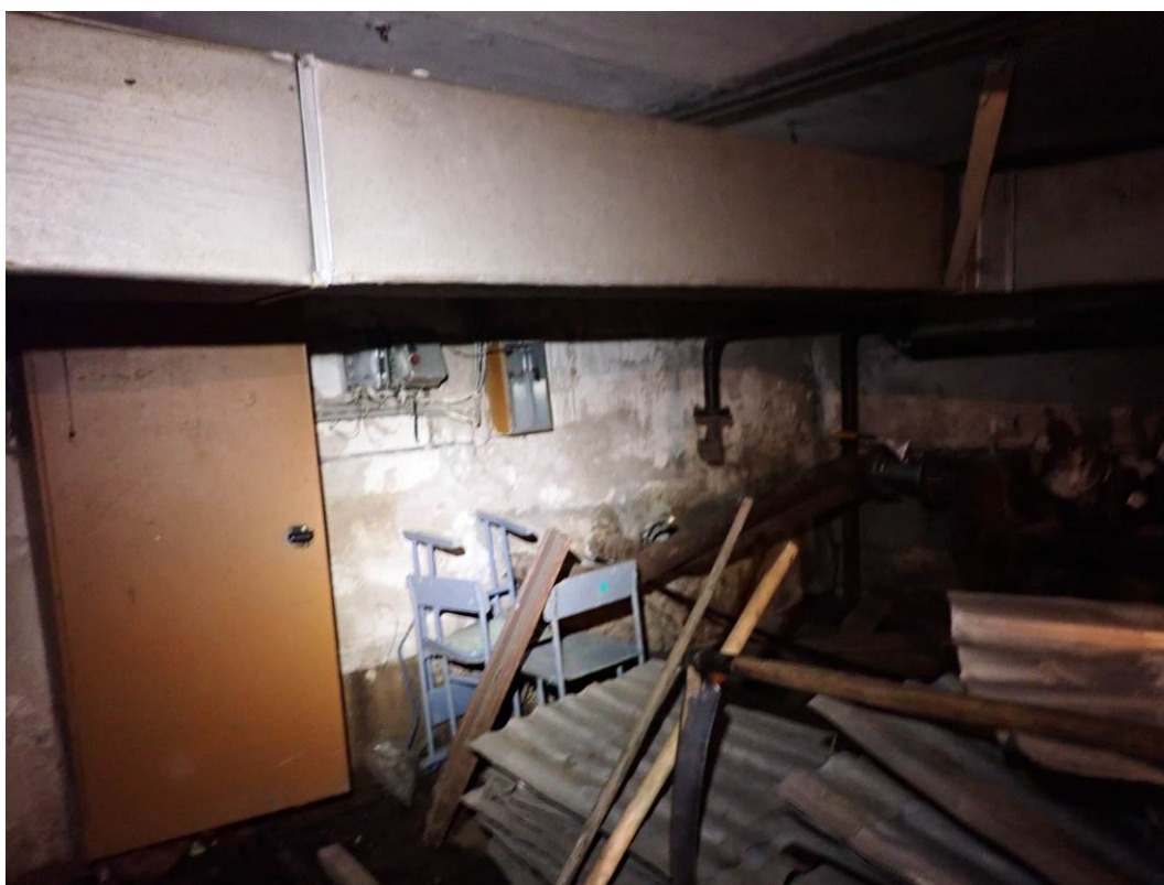
Фото 72. Повреждение отделочного слоя стен подвала ввиду наличия протечек трубопроводов.
