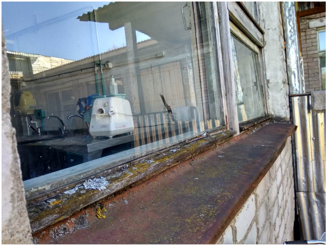
Фото 46. Гниение деревянных оконных блоков, биопоражение, повреждение окрасочного слоя. Коррозия металла оконных отливов.
