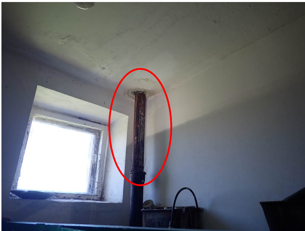
Фото 82. Протечки трубопроводов инженерных коммуникаций, их коррозия.
