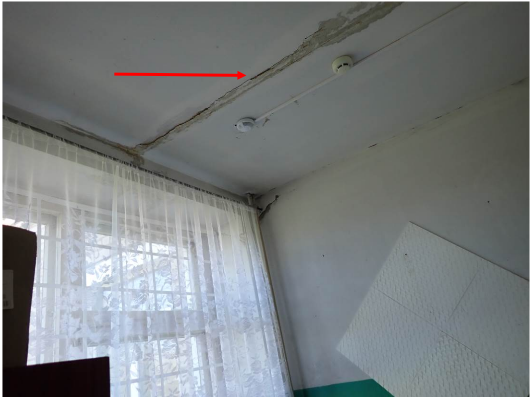
Фото 28. Наличие трещин в местах стыка плит междуэтажного перекрытия, повреждение отделки.
