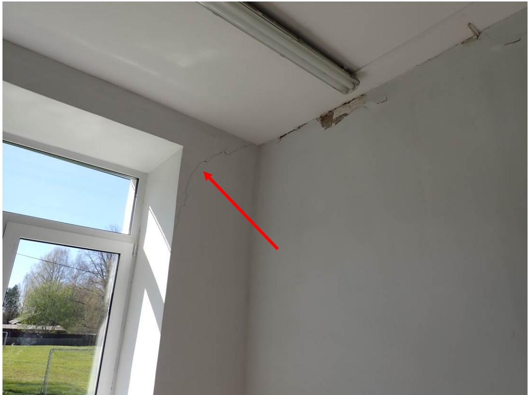
Фото 21. Наличие трещин в кирпичной кладке наружных стен. Наличие трещин в местах стыка стен со смежными конструкциями.
