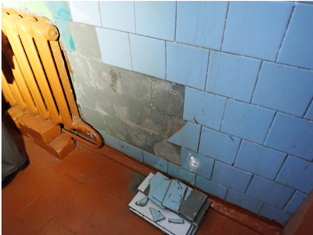
Фото 71. Повреждение отделки стен из керамической плитки, трещины, отсутствие локальных плиток.
