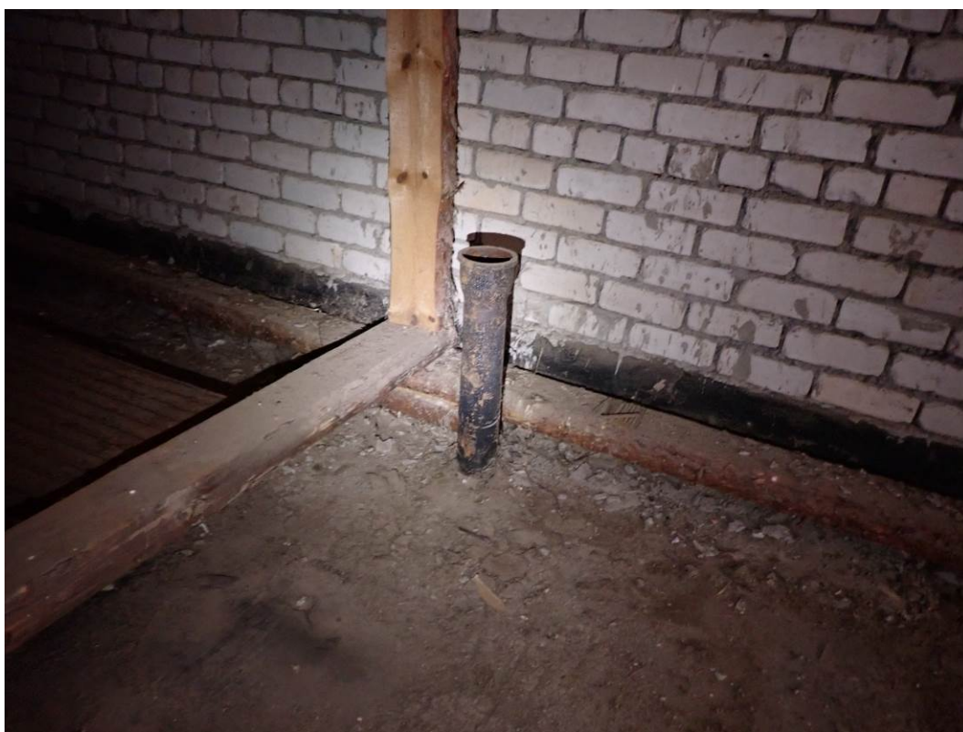
Фото 87. Отсутствие вывода фановых стояков за пределы кровли здания.
