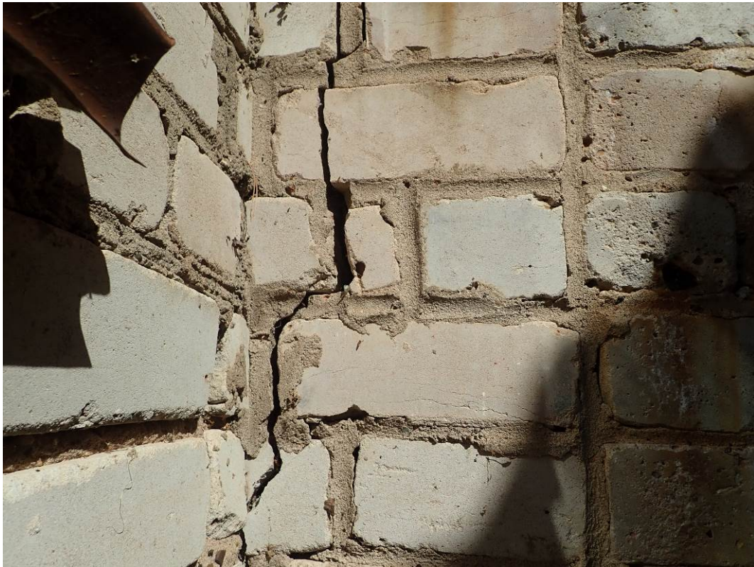
Фото 11. Трещины в кирпичной кладке наружных стен здания.
