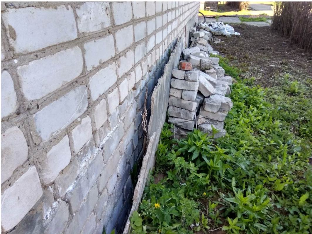
Фото 3. Локальное отсутствие бетонной отмостки здания. Замачивание цоколя, повреждение штукатурного слоя.
