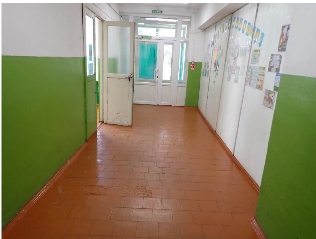
Фото 44. Повреждение покрытия полов из керамической плитки, локальное отсутствие плиток.
