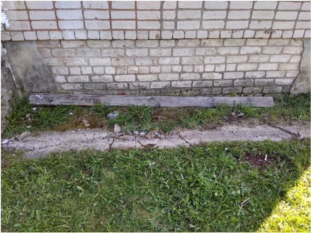
Фото 2. Повреждение бетонной отмостки здания, отхождение от наружных стен, трещины, прорастание растительности. Замачивание цоколя, биопоражение.
