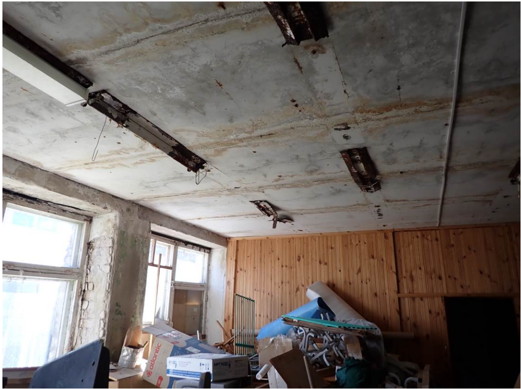
Фото 63. Повреждение отделки потолков.
