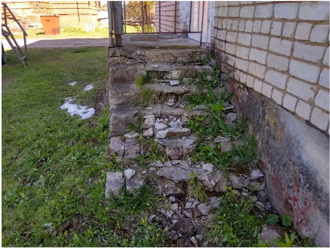
Фото 91. Повреждение кирпичной кладки и штукатурного слоя крылец запасных выходов, их локальные разрушения, прорастание растительности.
