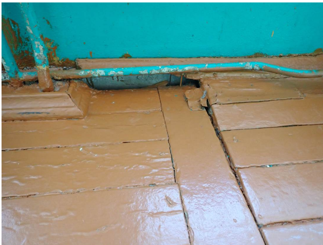
Фото 40. Повреждение дощатых полов здания, зазоры, просадка пола.
