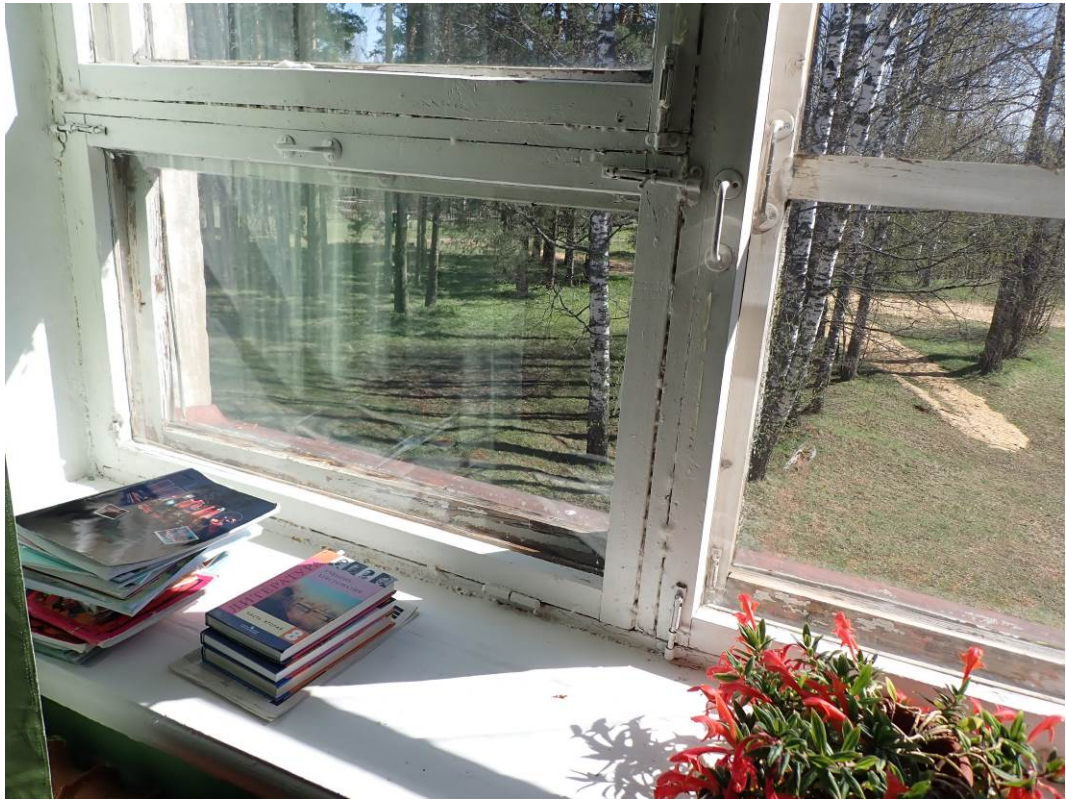
Фото 56. Гниение деревянных оконных блоков, биопоражение, повреждение окрасочного слоя.
