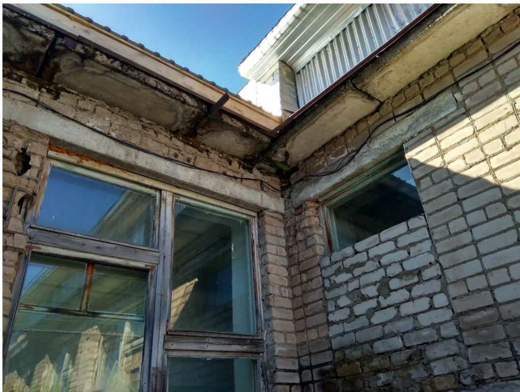
Фото 34. Повреждение железобетонных карнизных плит, оголение арматуры, коррозия.
