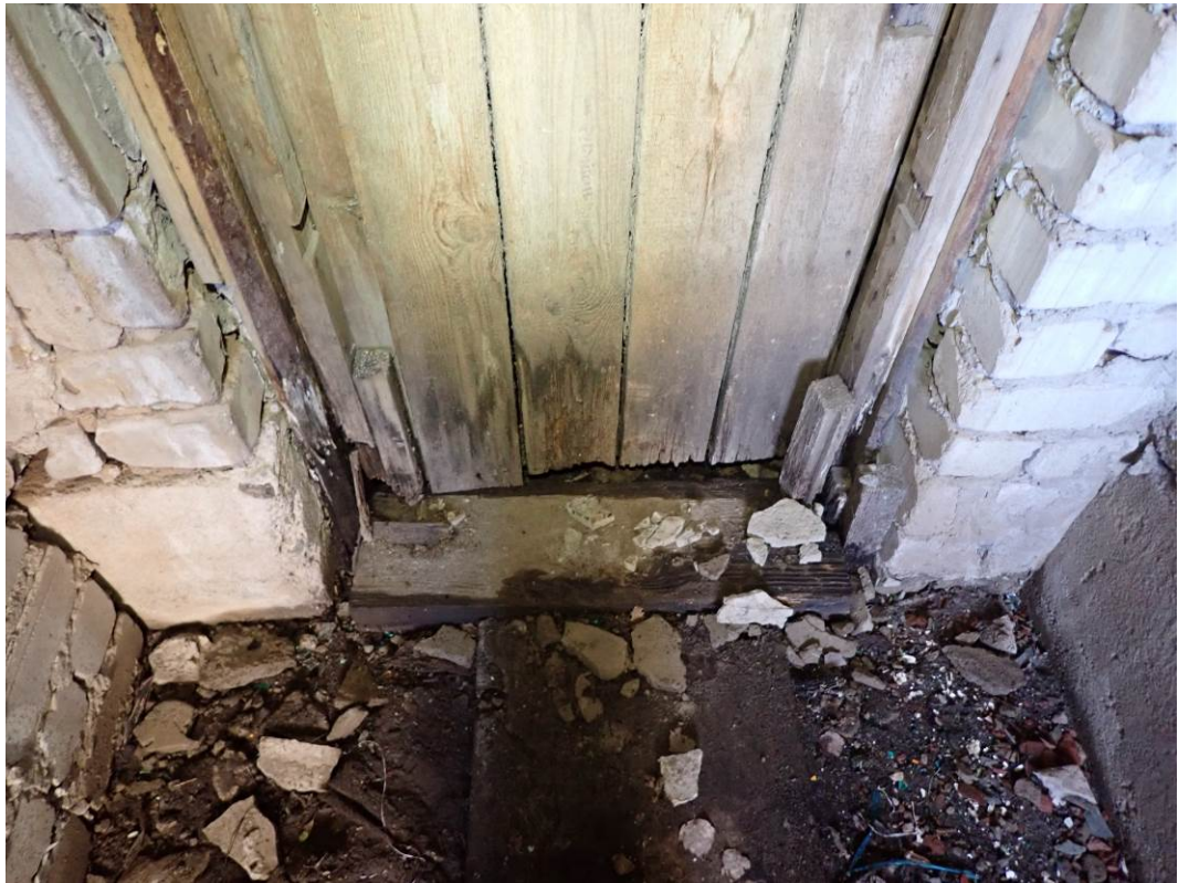
Фото 60. Замачивание, гниение деревянной двери входа в подвал, биопоражение.
