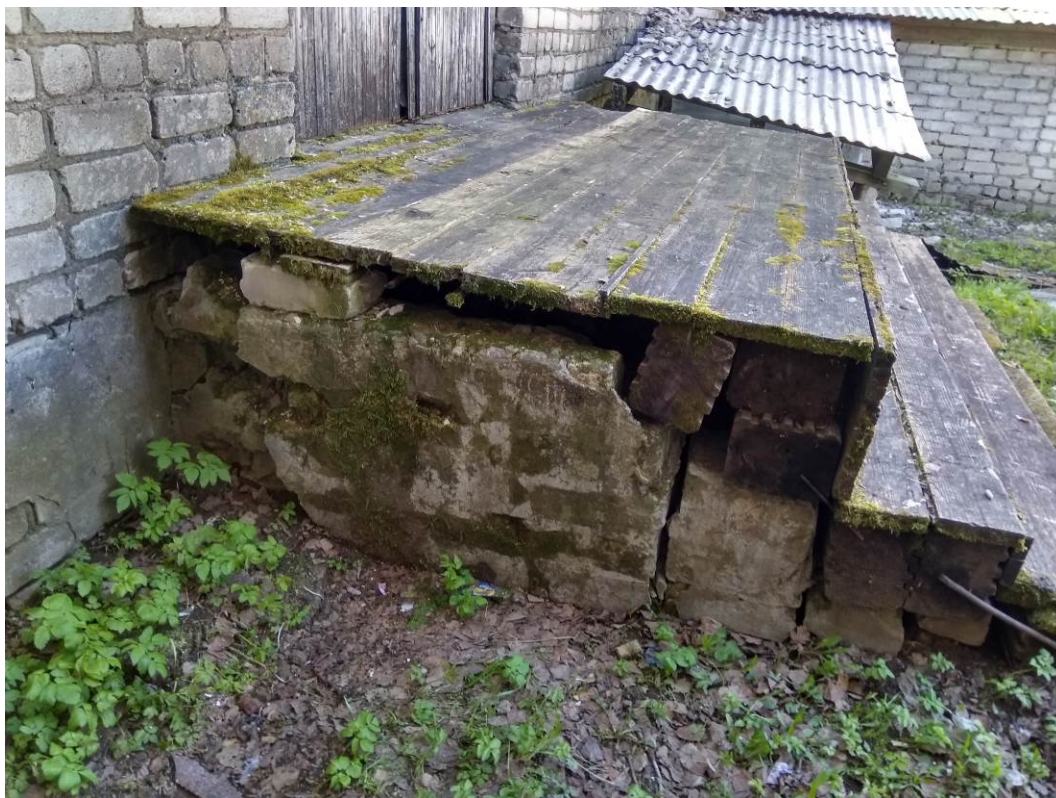
Фото 93. Повреждение кирпичной кладки и штукатурного слоя крылец запасных выходов, гниение дощатого покрытия, биопоражения, их локальные разрушения.
