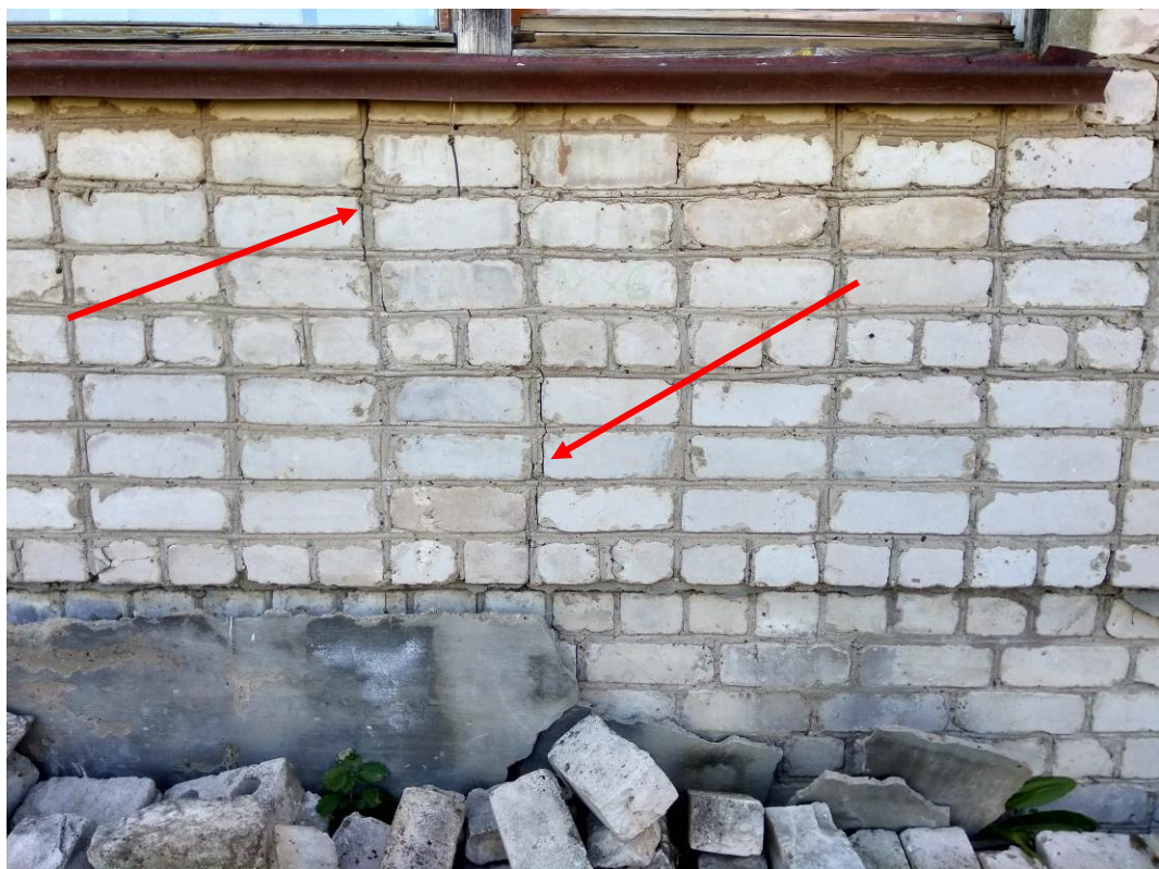
Фото 10. Трещины в кирпичной кладке наружных стен здания.
