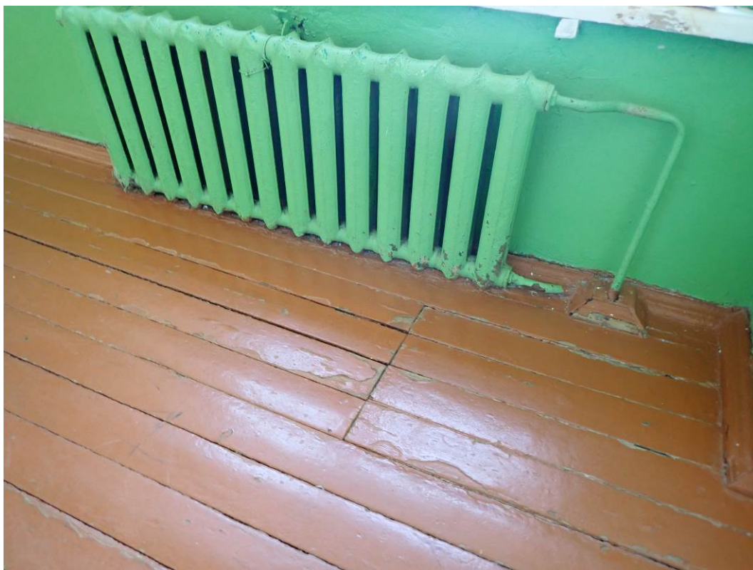
Фото 38. Повреждение дощатых полов здания, зазоры, истирание окрасочного слоя.
