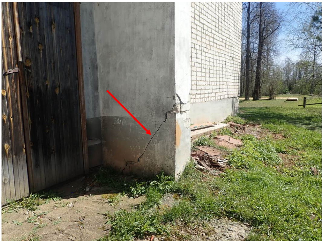
Фото 14. Повреждение кладки стен здания, трещины.
