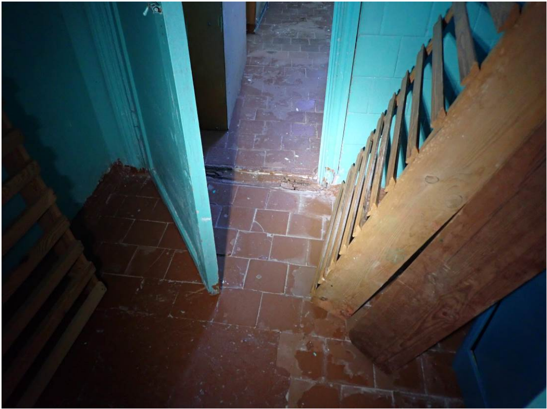
Фото 41. Повреждение покрытия полов из керамической плитки, наличие трещин, локальное отсутствие плиток.
