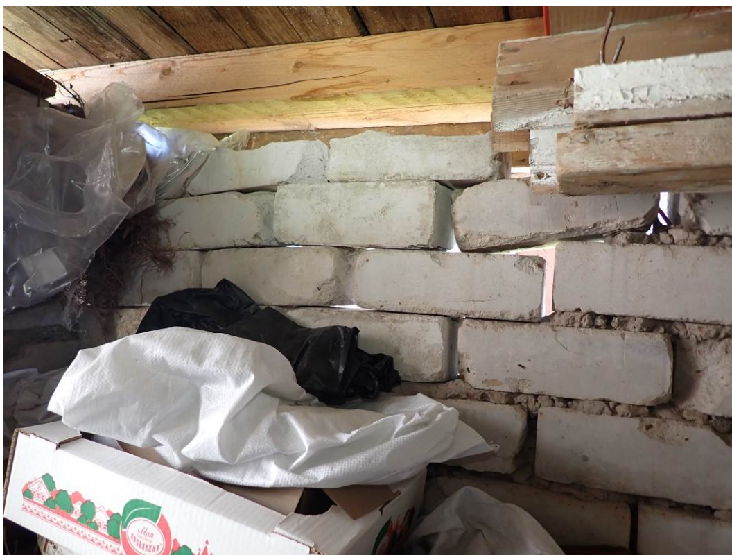
Фото 26. Некачественная кирпичная кладка ограждающих конструкций входа в подвал.
