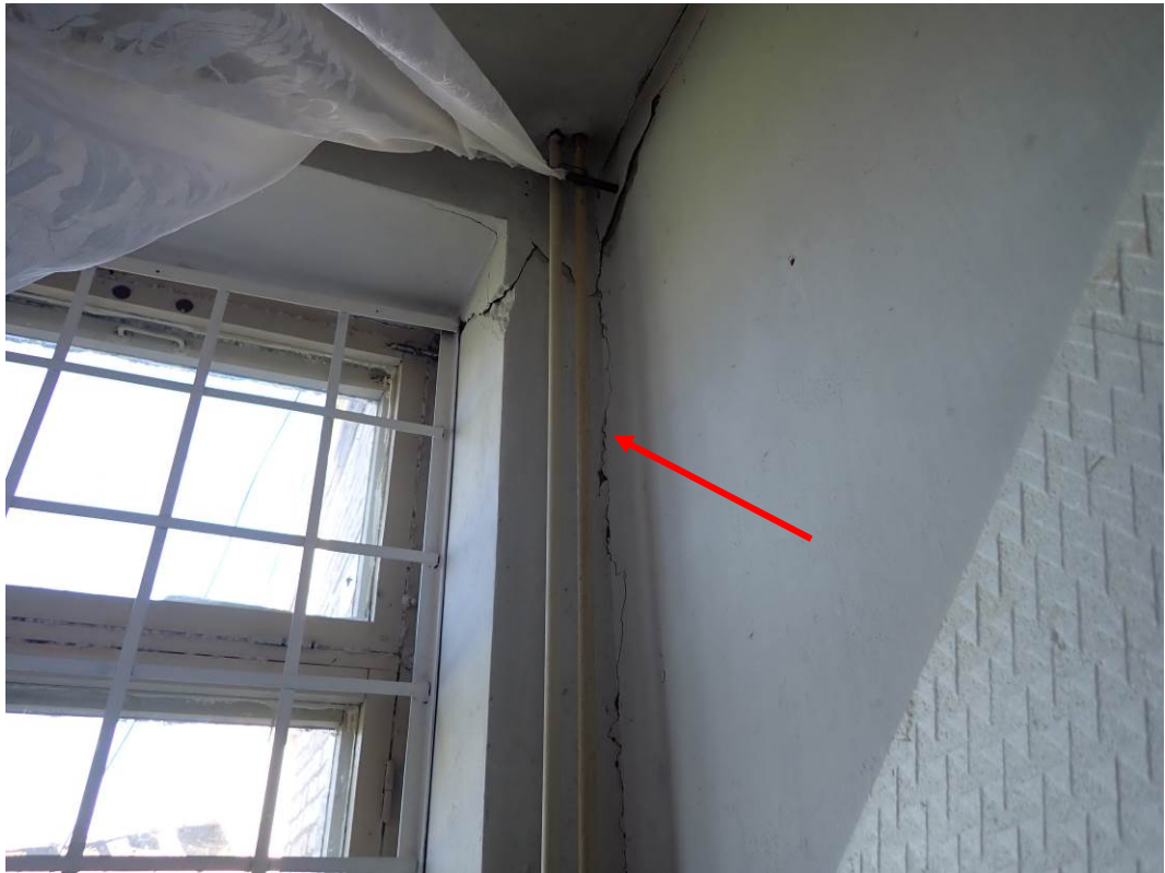
Фото 15. Наличие трещин в местах стыка стен со смежными конструкциями.
