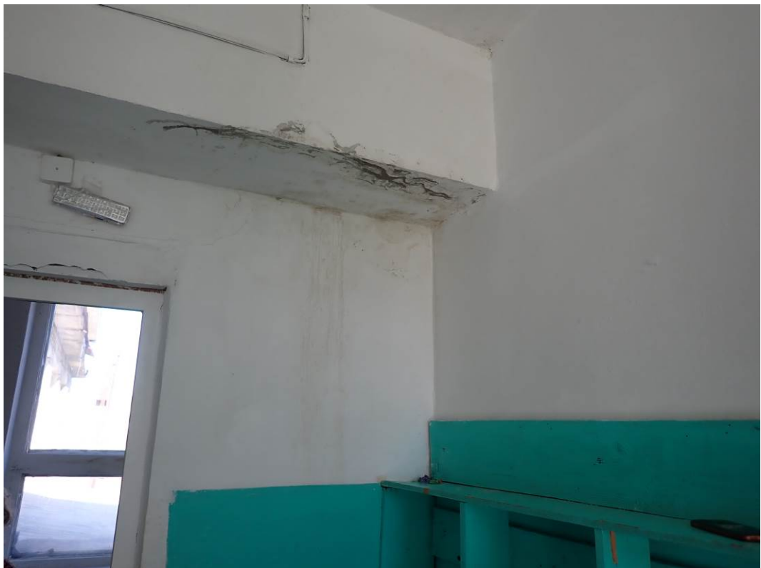
Фото 68. Повреждение окрасочного слоя стен изнутри здания, отслоения.
