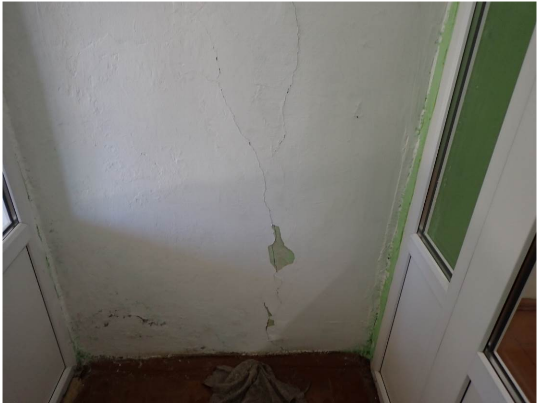
Фото 23. Наличие трещин в кирпичной кладке внутренних стен.
