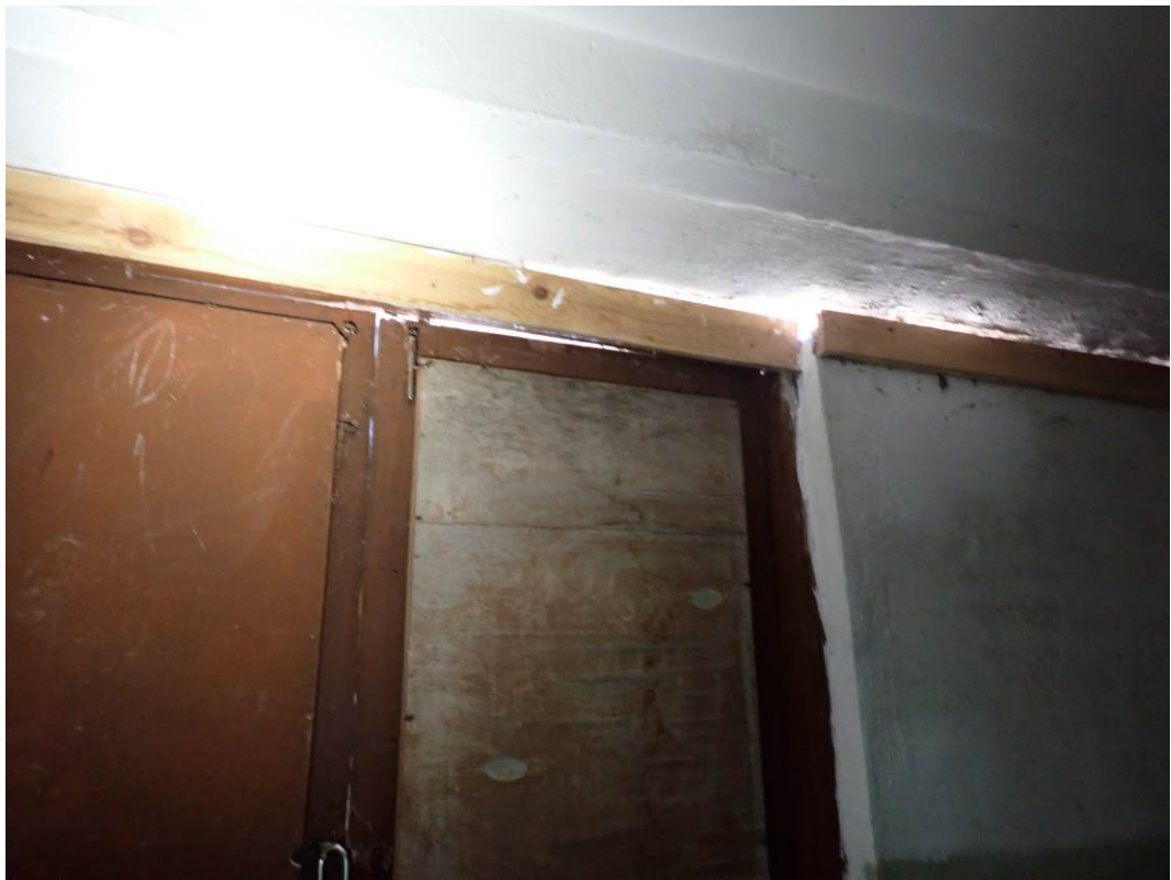
Фото 54. Повреждение деревянных полотен наружных дверей, их перекос.
