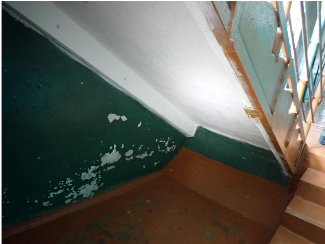
Фото 67. Повреждение окрасочного слоя стен изнутри здания (шелушение).
