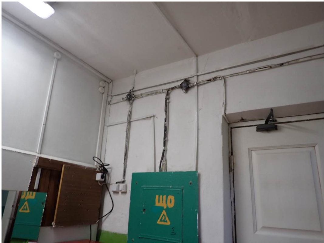
Фото 76. Отсутствие коробов для прокладки электропроводки.
