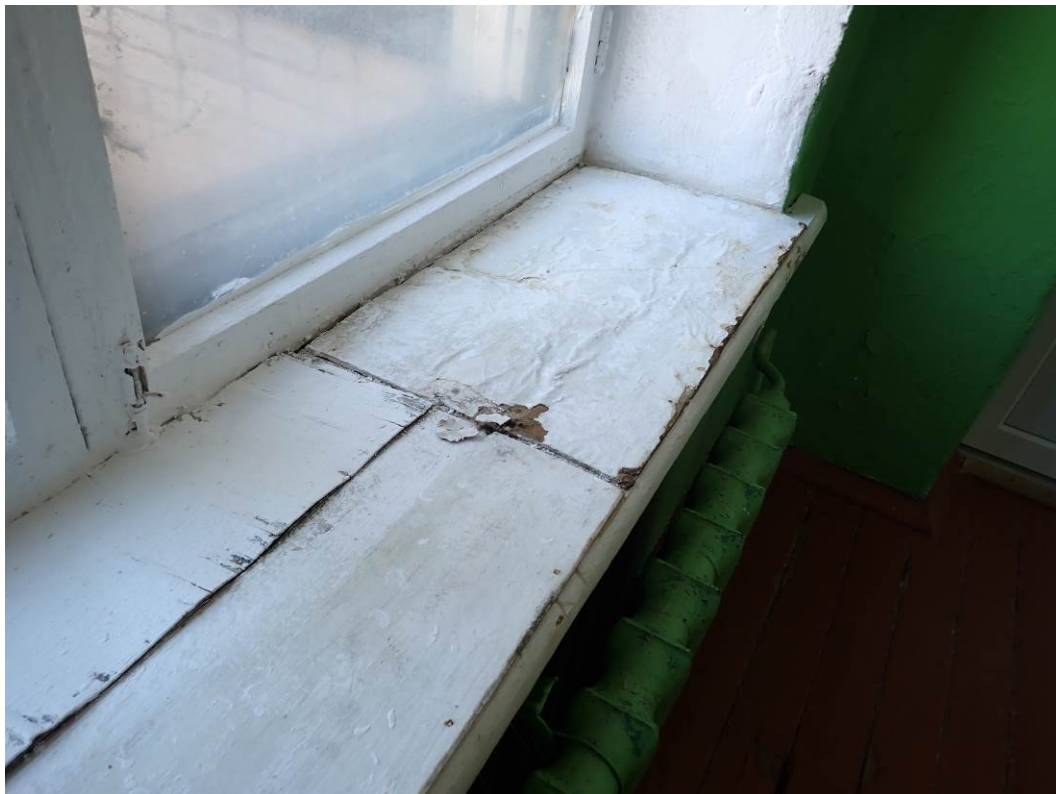
Фото 50. Повреждение деревянных подоконников здания.
