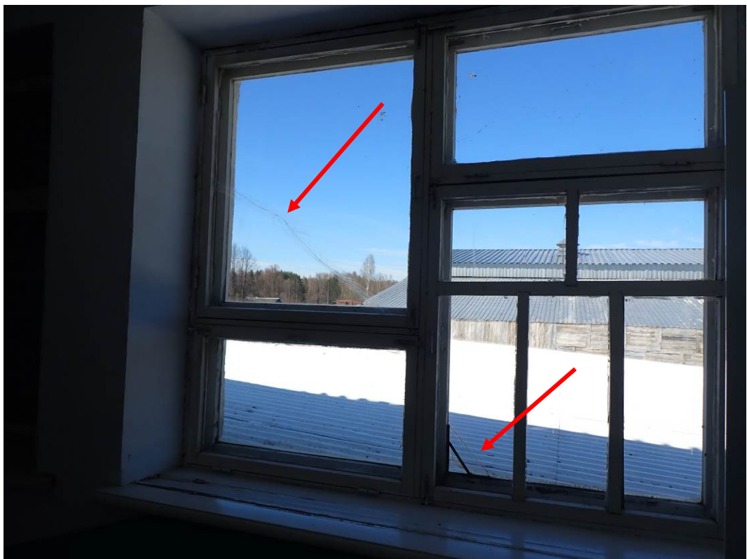
Фото 59. Повреждение остекления локальных оконных блоков.
