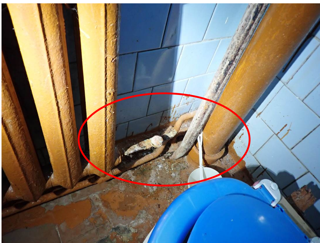
Фото 83. Коррозия металла трубопроводов инженерных коммуникаций.
