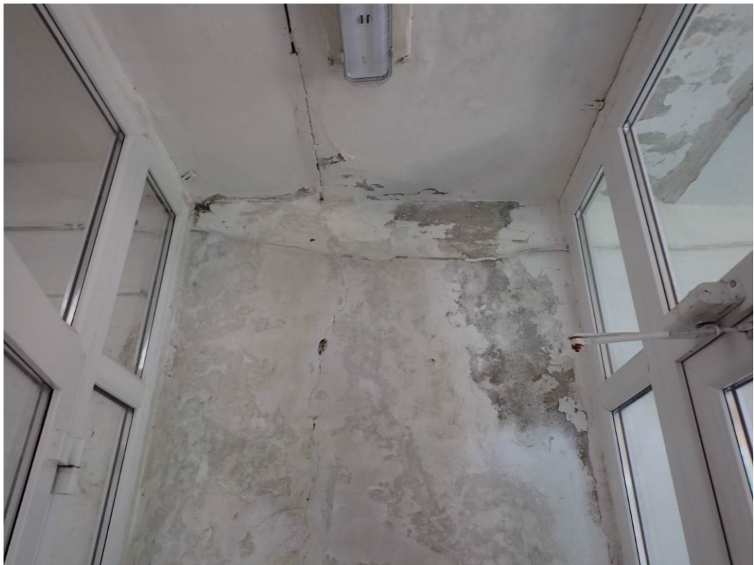
Фото 70. Повреждение отделки стен внутри здания ввиду замачивания.
