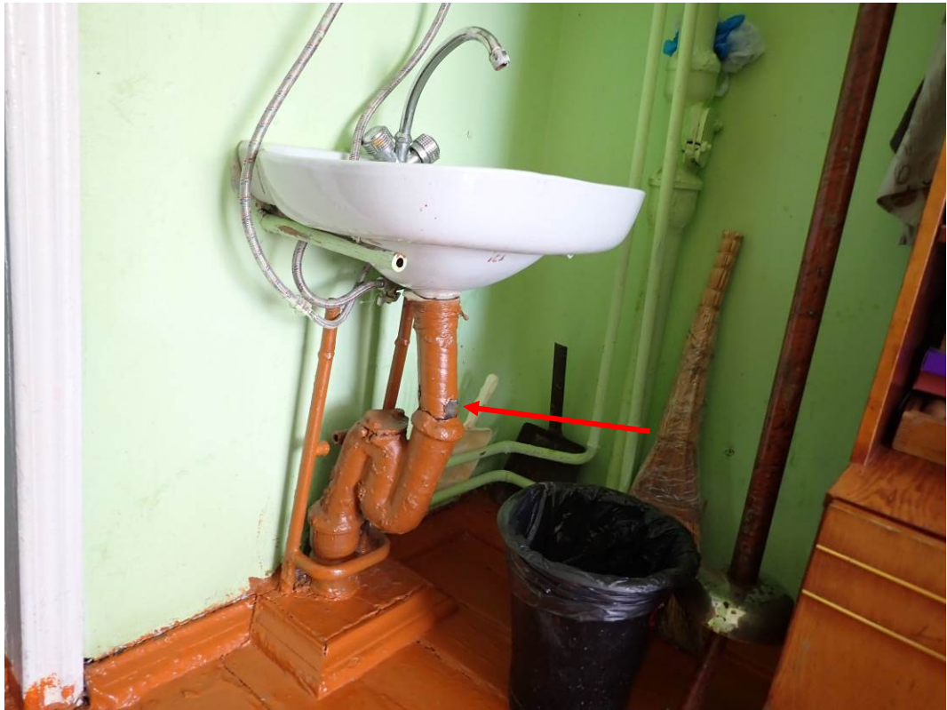
Фото 78. Повреждение канализационных сливов для раковин, коррозия.
