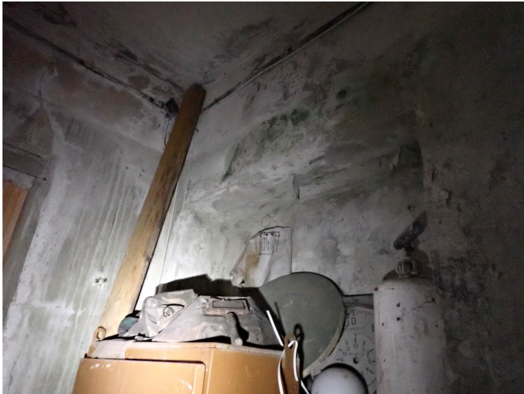
Фото 73. Повреждение отделочного слоя стен подвала ввиду наличия протечек трубопроводов, биопоражения.
