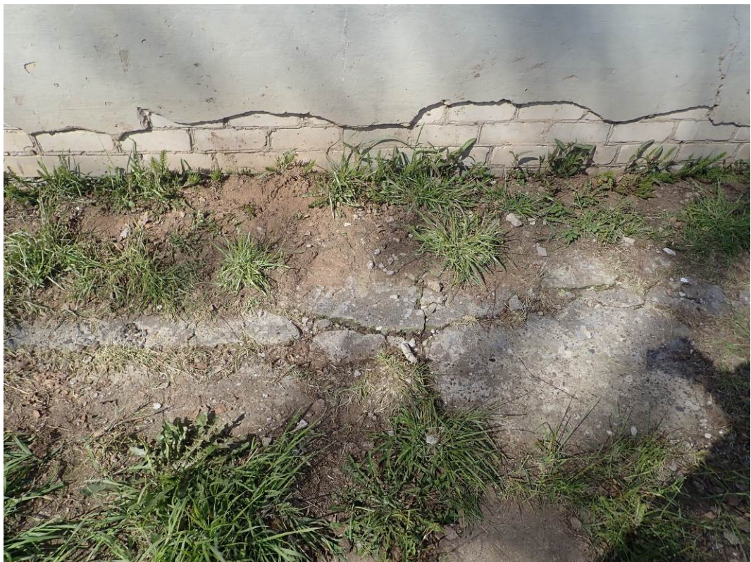
Фото 5. Повреждение бетонной отмостки здания, трещины, прорастание растительности. Замачивание цоколя, повреждение штукатурного слоя.
