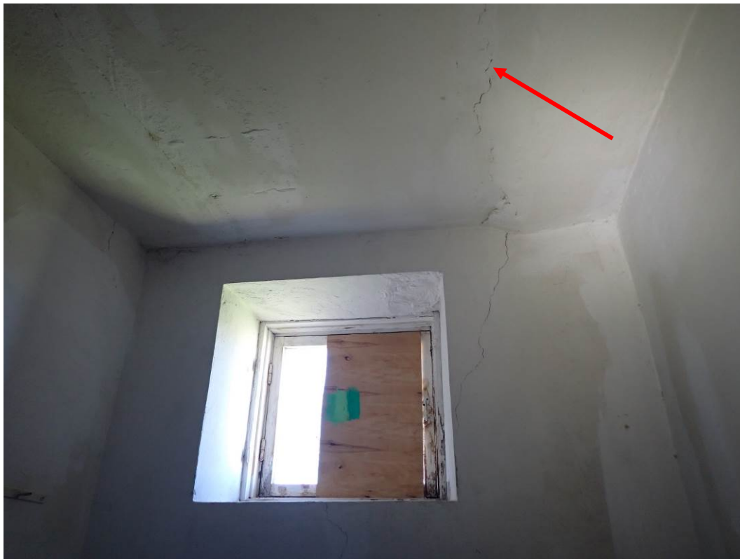
Фото 31. Трещины в швах между плитами перекрытия, повреждение отделочного слоя.
