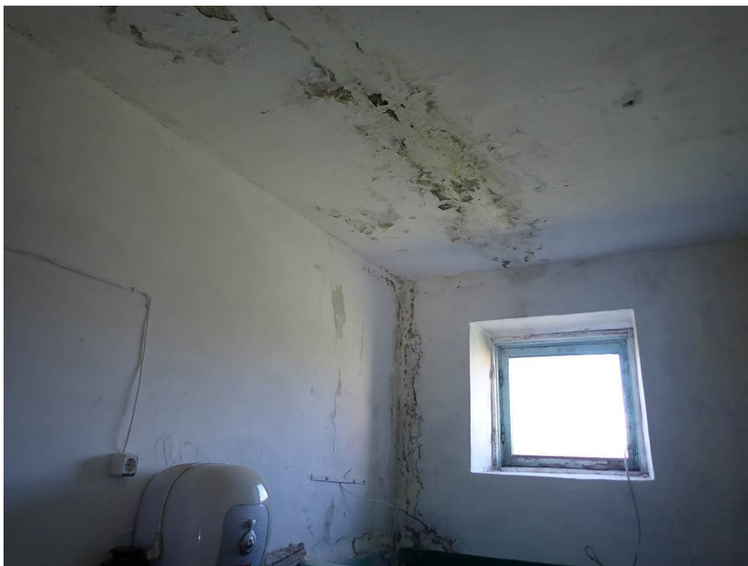
Фото 66. Повреждение окрасочного слоя стен и потолков внутри здания.
