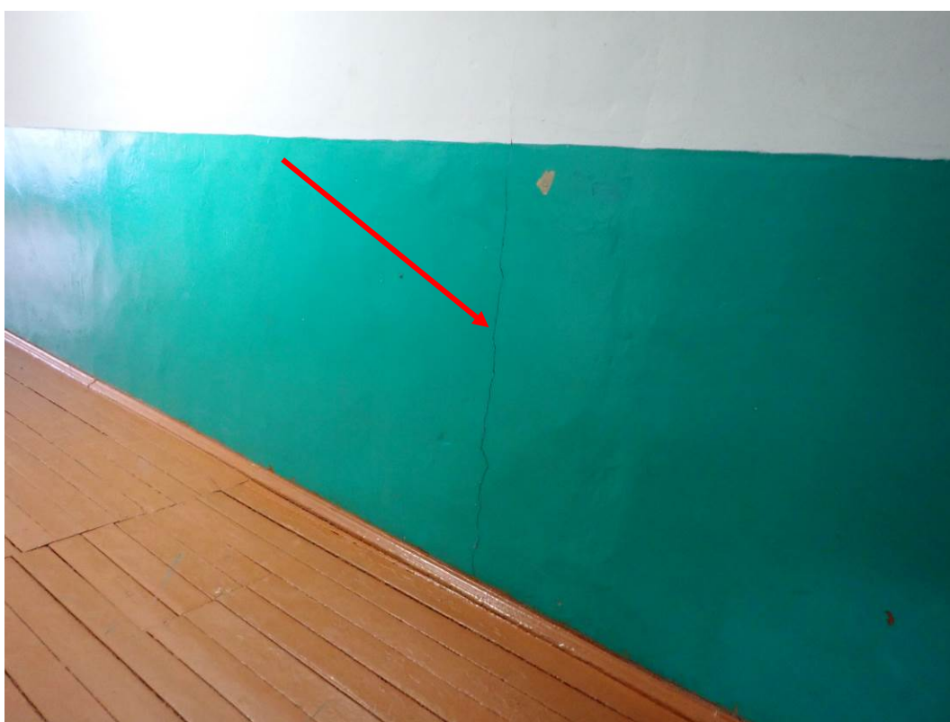
Фото 18. Трещины в кирпичной кладке внутренних стен здания.
