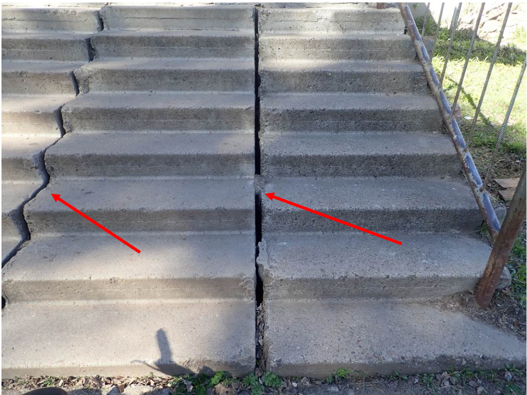
Фото 96. Отсутствие заполнения стыков между лестничными маршами крыльца главного входа в здание.
