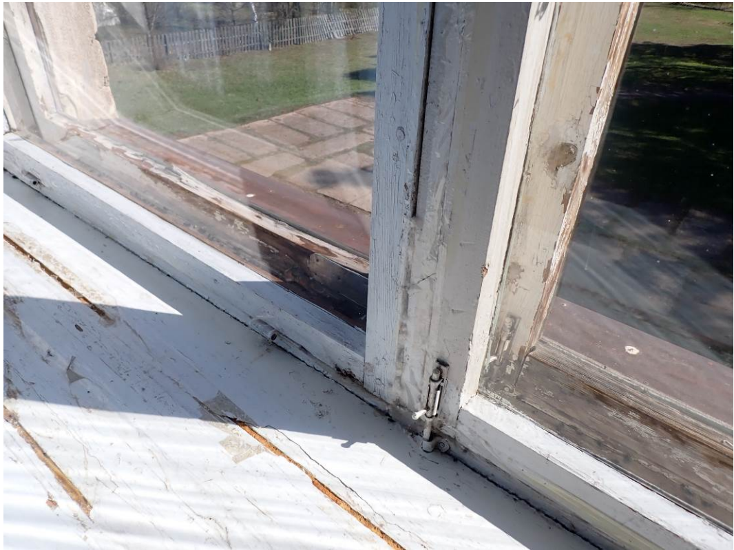
Фото 58. Гниение деревянных оконных блоков, биопоражение, повреждение окрасочного слоя.
