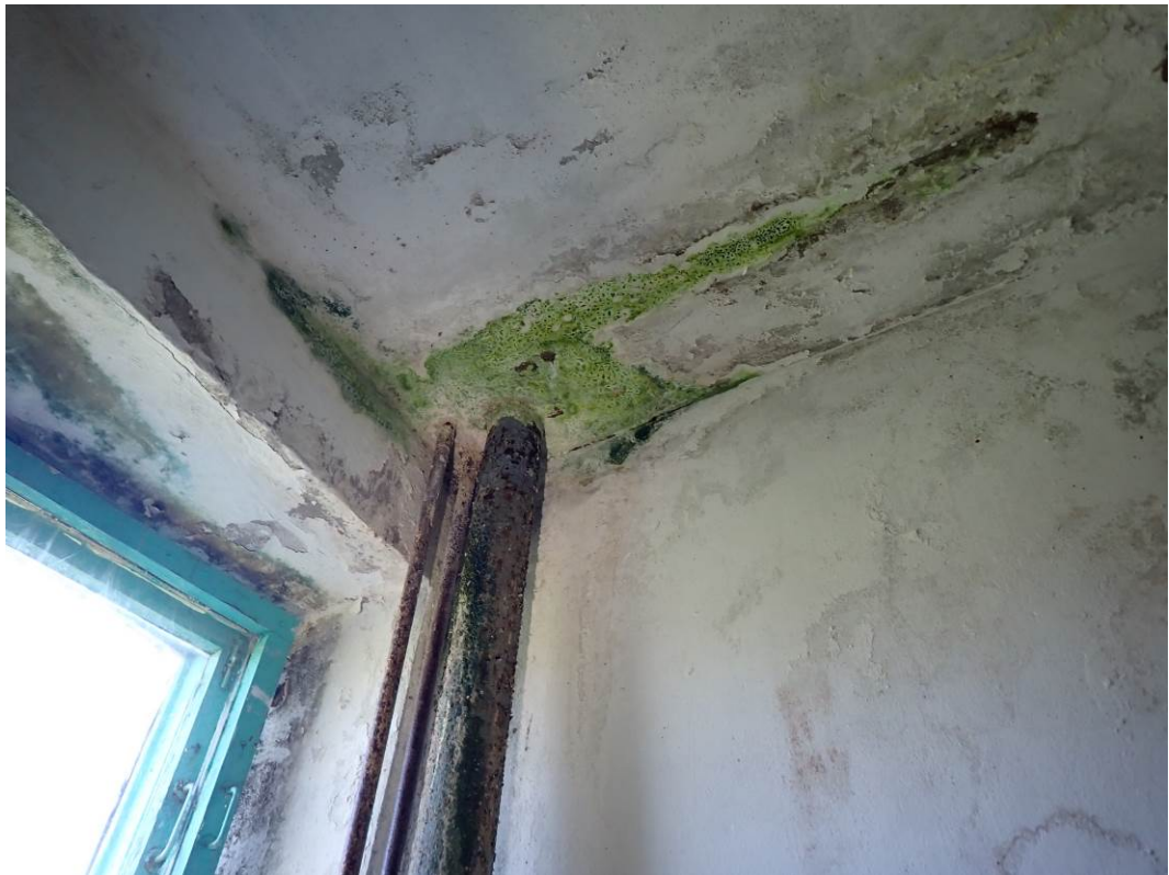
Фото 79. Протечки трубопроводов инженерных коммуникаций, их коррозия.
