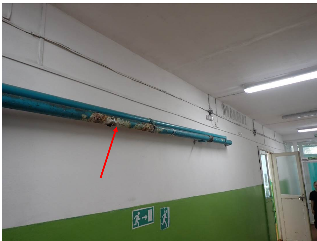
Фото 75. Коррозия металла трубопроводов инженерных коммуникаций.
