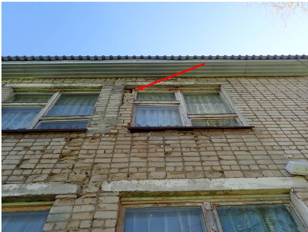
Фото 12. Повреждение лицевой кирпичной кладки наружных стен, биопоражение. Локальные разрушения кирпичной кладки наружных стен здания.
