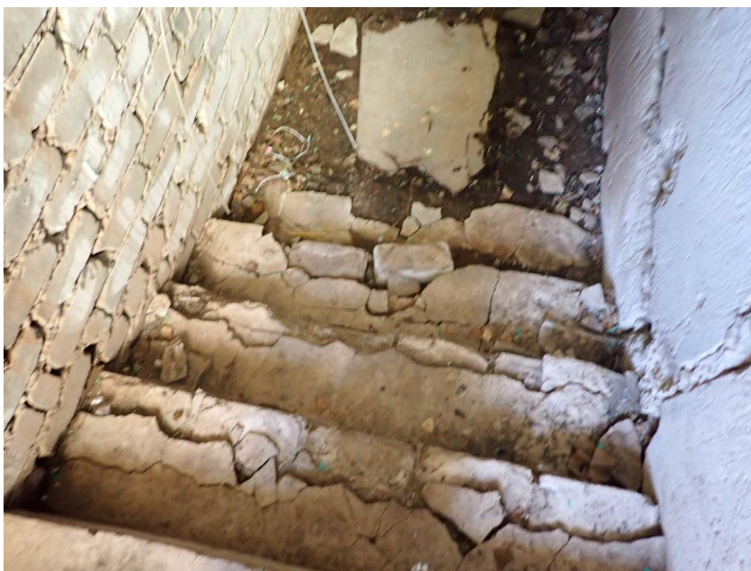
Фото 100. Разрушение бетона лестницы спуска в подвал.
