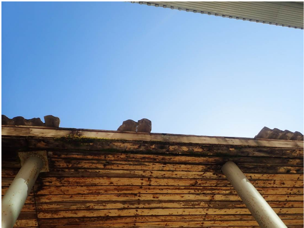
Фото 97. Замачивание, гниение деревянных элементов козырька главного входа в здание, повреждение покрытия из асбестоцементных волнистых листов.
