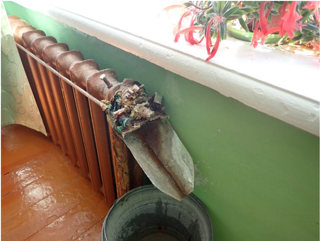
Фото 80. Коррозия металла радиаторов отопления, локально отсутствие запорной арматуры, протечки.
