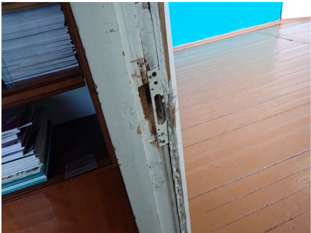
Фото 49. Повреждение деревянных полотен внутренних дверей.
