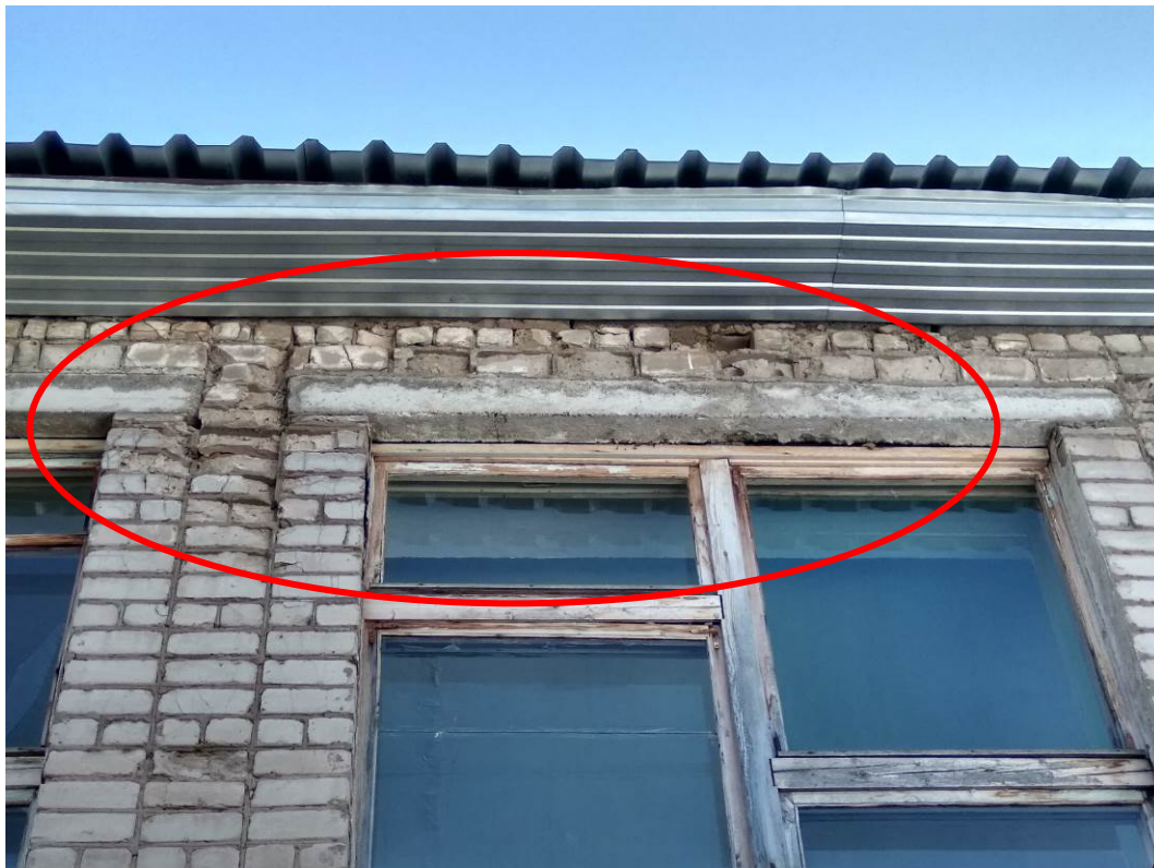
Фото 7. Повреждение лицевой кирпичной кладки наружных стен.
