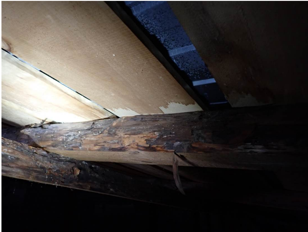
Фото 36. Следы замачивания деревянных элементов стропильной системы здания.
