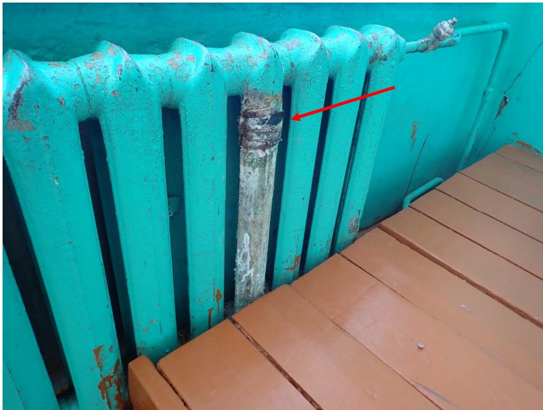
Фото 84. Коррозия металла радиаторов отопления, следы ремонтов, протечки.
