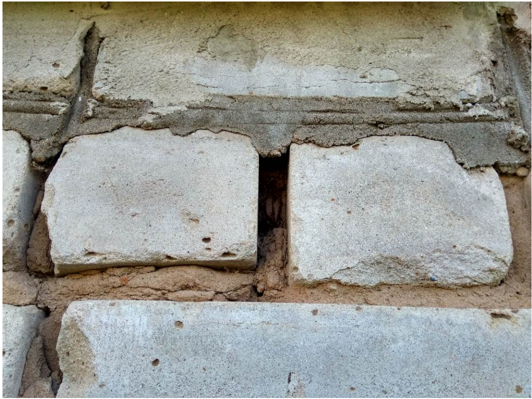
Фото 9. Некачественное заполнение швов кирпичной кладки наружных стен здания.
