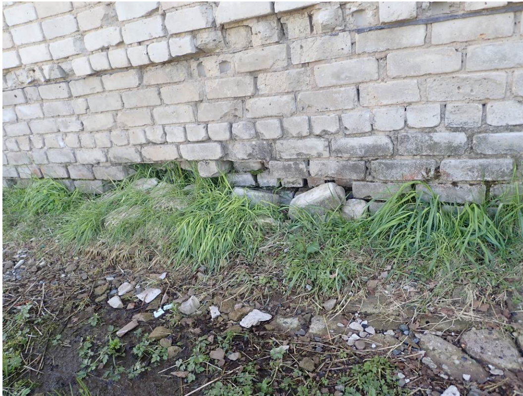
Фото 6. Повреждение бетонной отмостки здания, ее просадка, отхождение от наружных стен, прорастание растительности. Замачивание цоколя, повреждение штукатурного слоя и кирпичной кладки.
