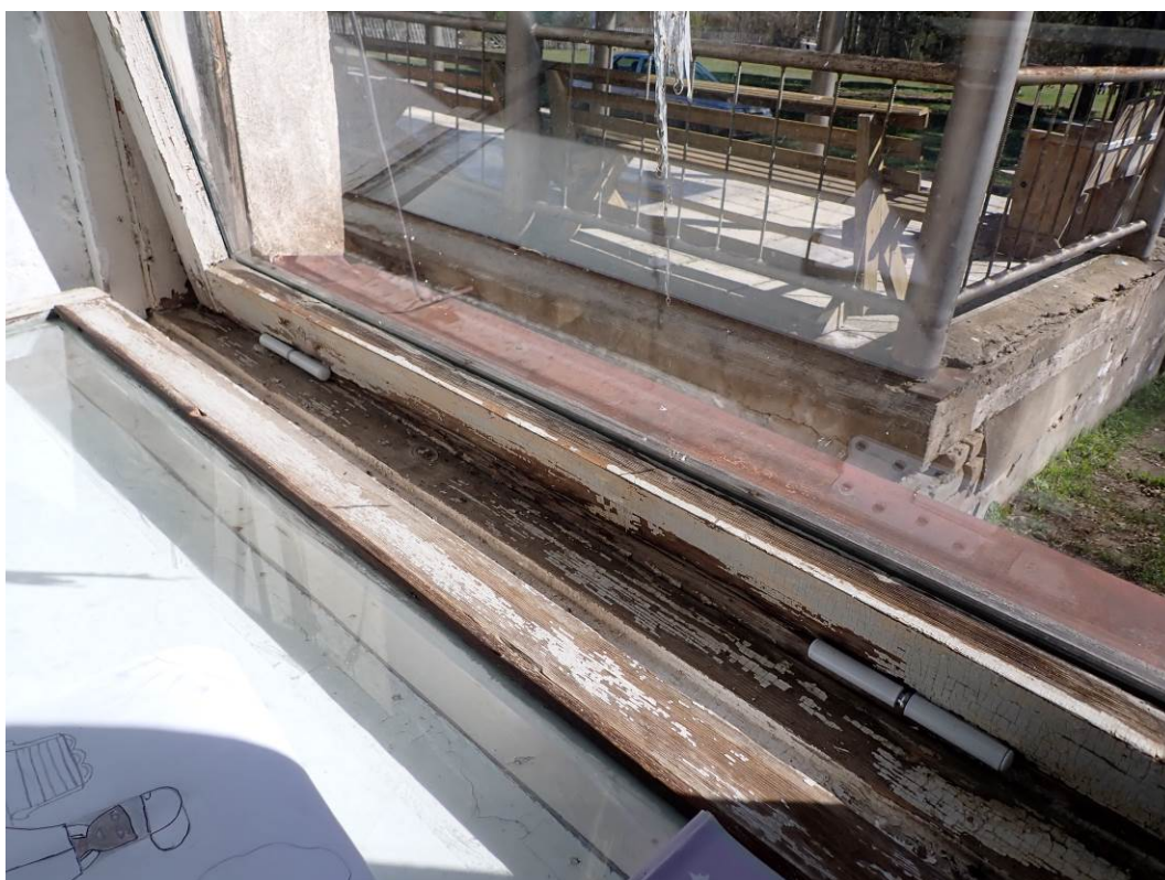
Фото 51. Гниение деревянных оконных блоков, биопоражение, повреждение окрасочного слоя. Коррозия металла оконных отливов.
