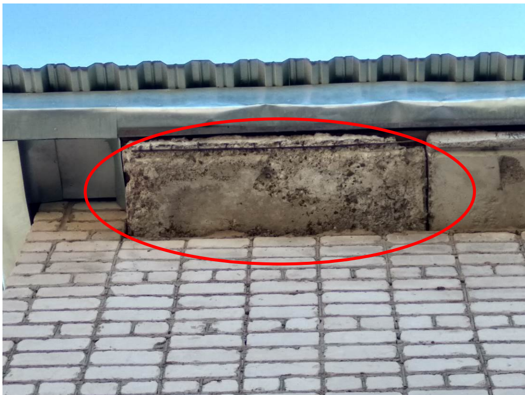
Фото 33. Повреждение железобетонных карнизных плит, оголение арматуры, коррозия.
