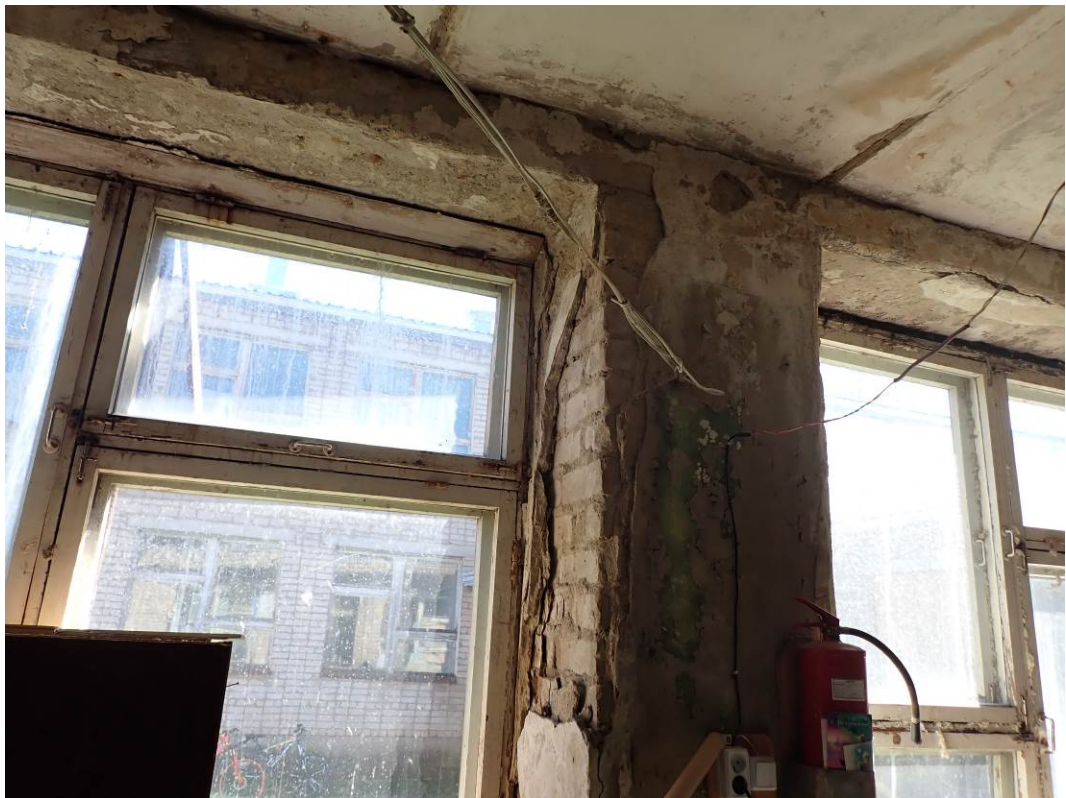
Фото 64. Повреждение штукатурного и окрасочного слоя стен и потолков изнутри здания (шелушение).
