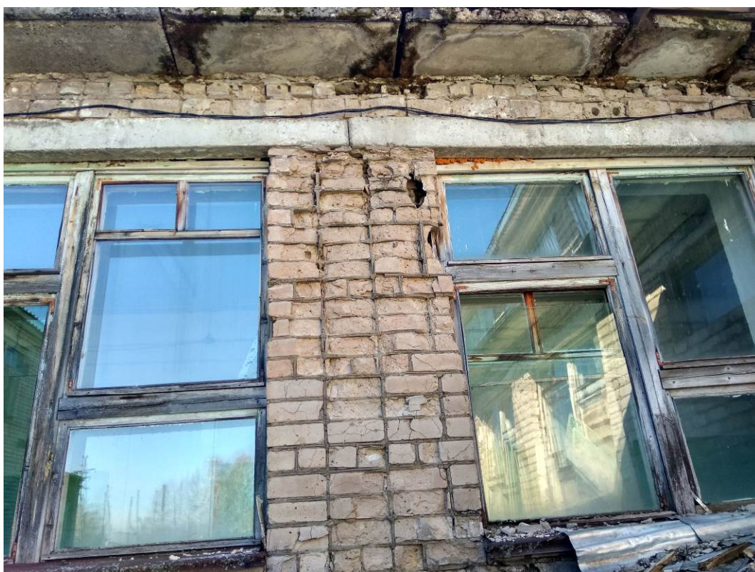
Фото 8. Повреждение лицевой кирпичной кладки наружных стен, биопоражение.
