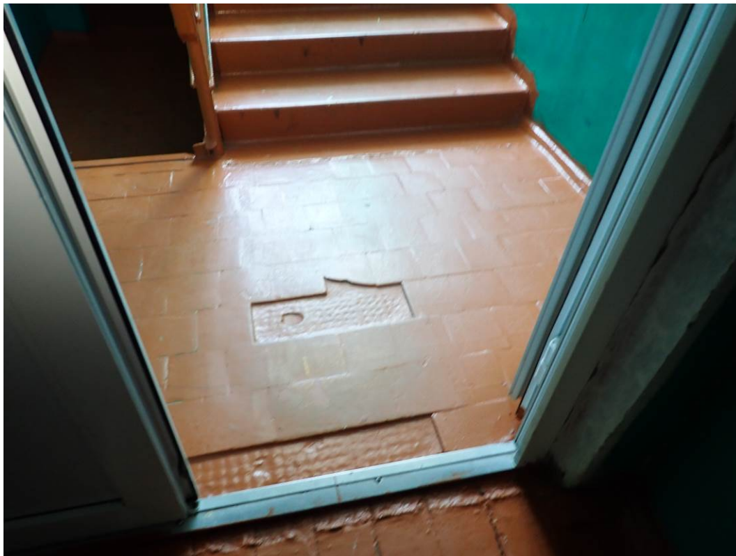
Фото 43. Повреждение покрытия полов из керамической плитки, локальное отсутствие плиток.
